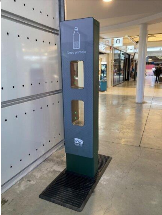
Fontaine à eau potable
