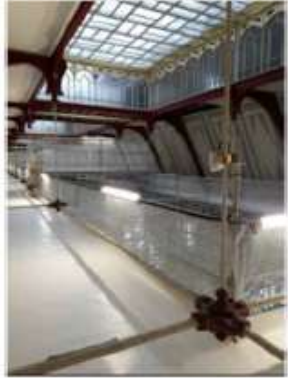
La Rochelle – Plafond, verrières, menuiseries, porte-automatique
