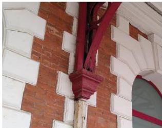
Corrosion + perte de matière
